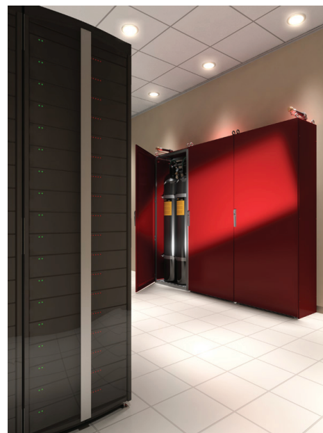
BREVET 7 686 093 - SYSTÈME D'EXTINCTION D'INCENDIE DOUBLE UTILISANT DES ÉMETTEURS À VITESSE ÉLEVÉE ET BASSE PRESSION. BREVETS ÉTRANGERS ÉGALEMENT EN INSTANCE ET ACCORDÉS.
